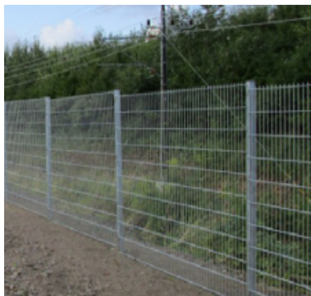
Bild 6: Panelstängsel längs järnvägslinje
